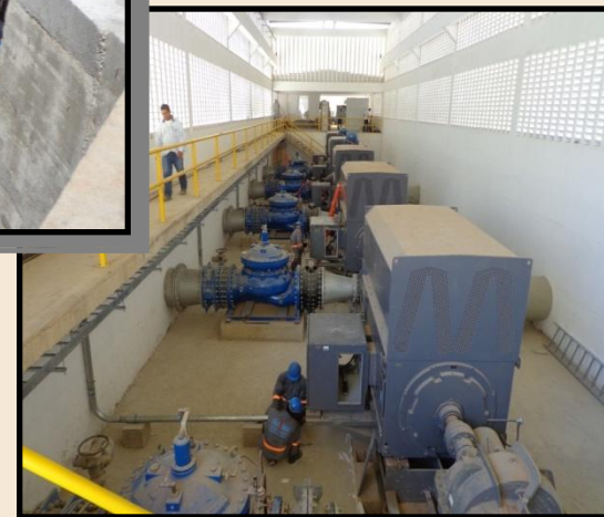
Eletrobombas da Estação Elevatória E.E 01.
