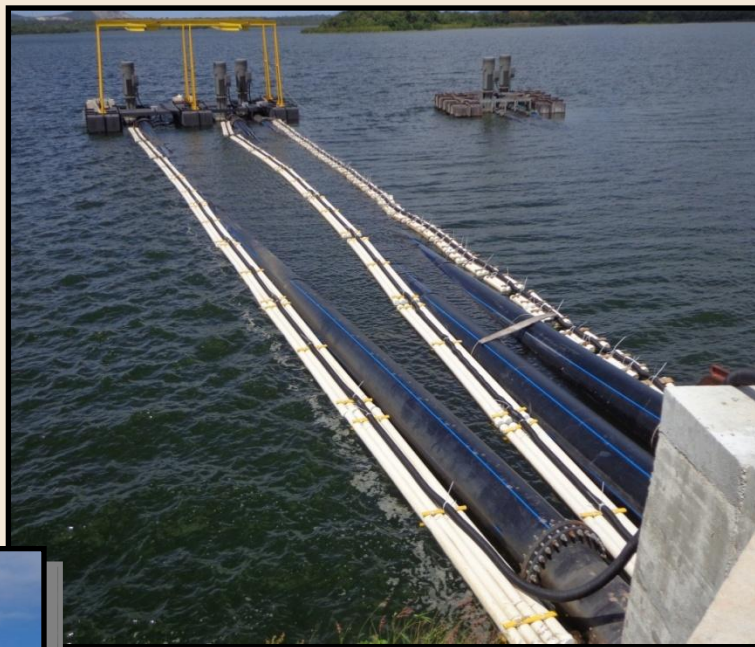
Captação/Estação Elevatória E.E 00 (Açude Gavião).
